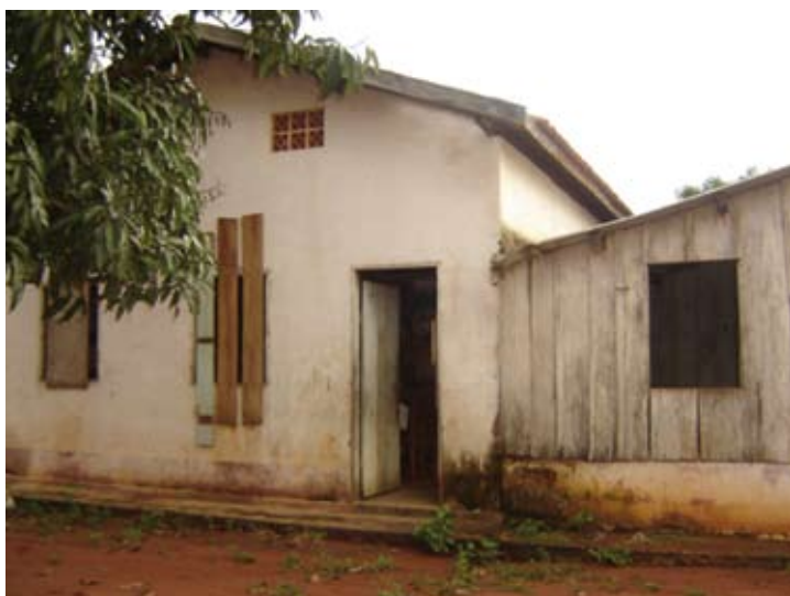
Het oude lesgebouw in Sapiquá was nodig aan vervanging toe
